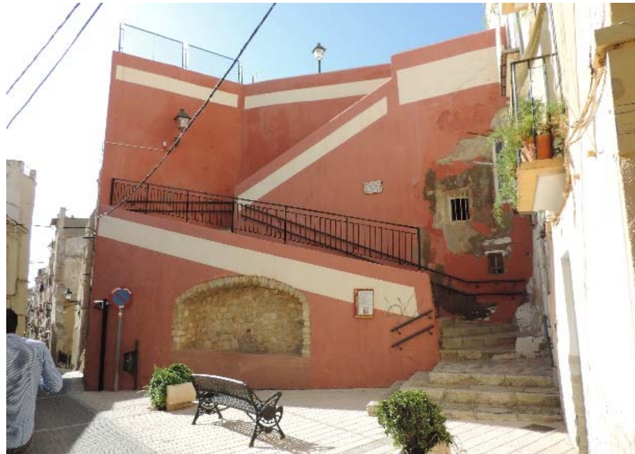
IMAGEN 6.7-e: ESCALONES QUE NO CUMPLEN LAS CONDICIONES EXIGIBLES POR LA NORMATIVA REFERENTES A HUELLAS, TABICAS Y DESCANSILLOS
