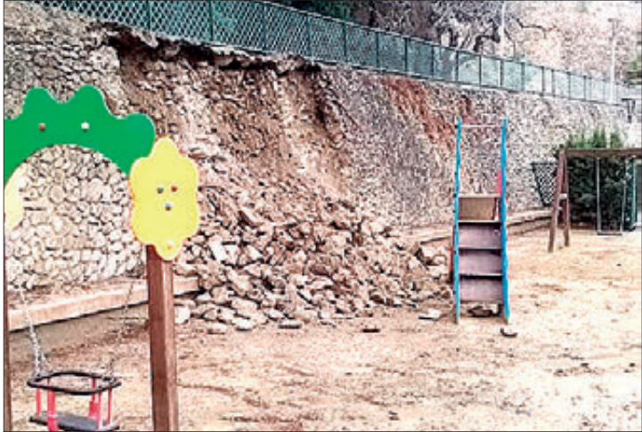
Caída de un muro del parque del Cuarnero.
