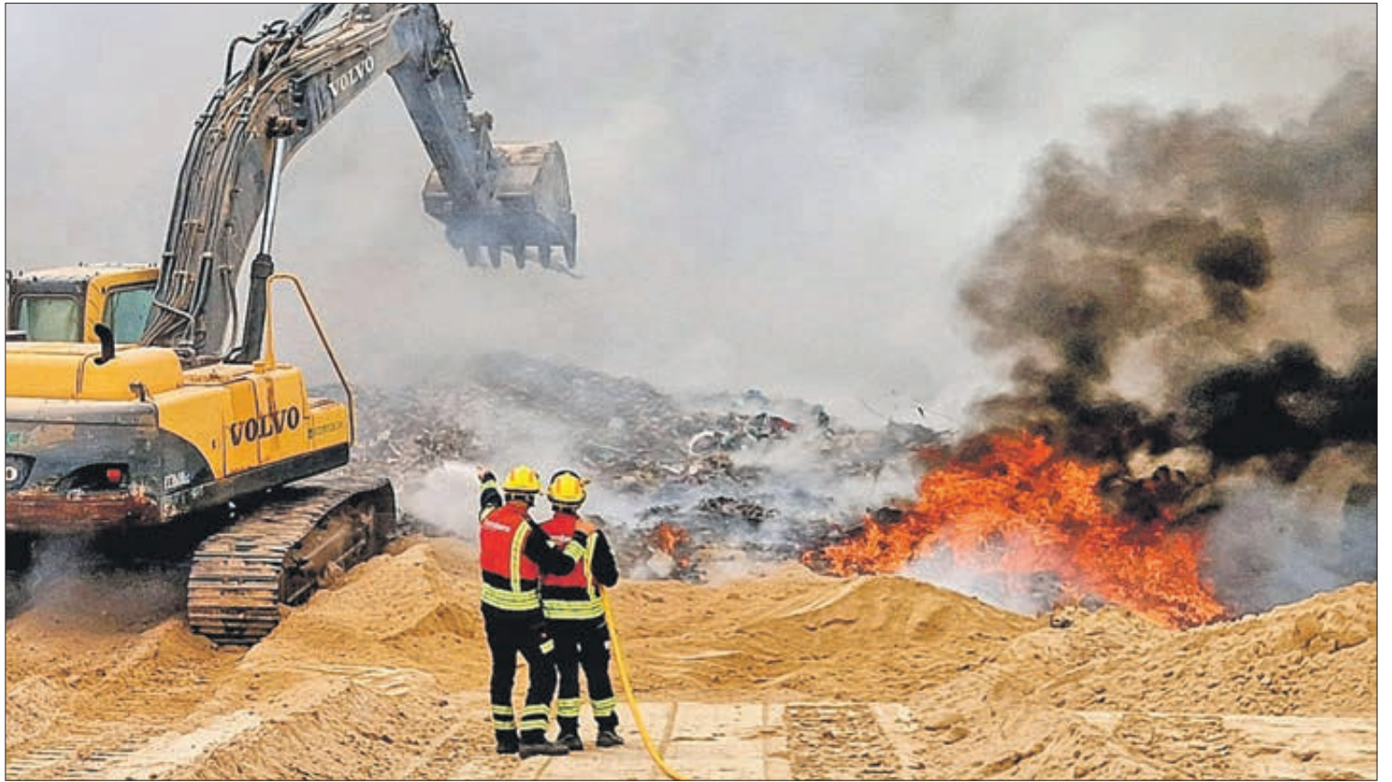
Imagen del incendio de este mes de julio en la planta Piedra Negra.
